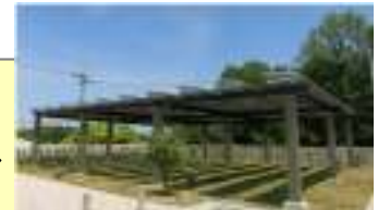
調整池上部(共用部)の太陽光発電システム(17.1kW)
