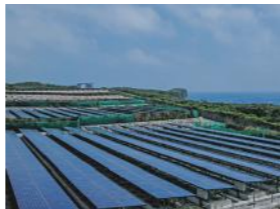
島南部の七又海岸の約10万m 2 の敷地に、総出力4,000kWの太陽光発電設備を設置。年間発電量は一般家庭約1,200世帯分の電気使用量に相当する。
