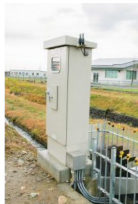
施設を流れる二俣川のバイパス水路にマイクロ水力発電設備を導入。
