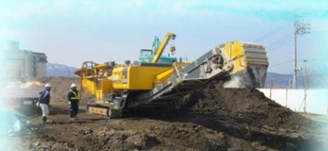
ヒ素汚染土壌不溶化処理 病院民間企業 病院敷地内ヒ素汚染土壌不溶化処理工事
