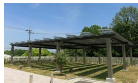
調整池上部(共用部)の太陽光発電設備(17.1kW)
